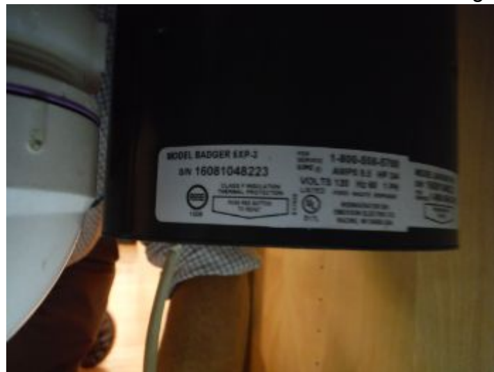
Data tag Garbage Disposal
