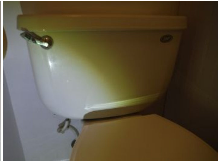
Loose toilet bowl
